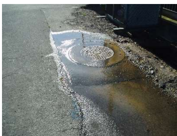
▲空気弁マンホールからの漏水事例
