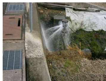
▲空気弁の漏水事例
