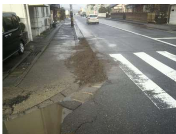
▲パイプラインの漏水事例
