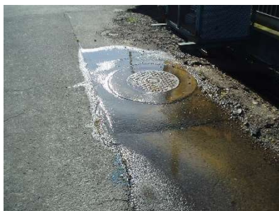
▲空気弁マンホールからの漏水事例
