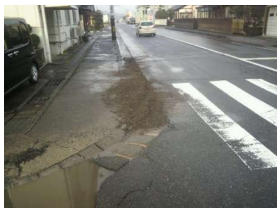
▲パイプラインの漏水事例
