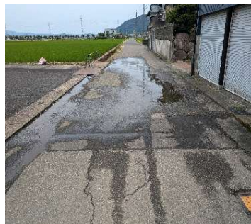
▲パイプラインの漏水事例
