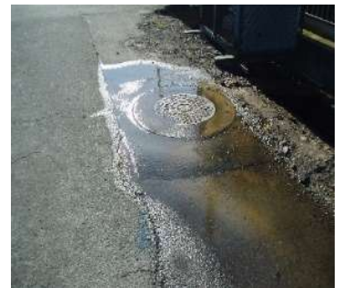
▲空気弁マンホールからの漏水事例
